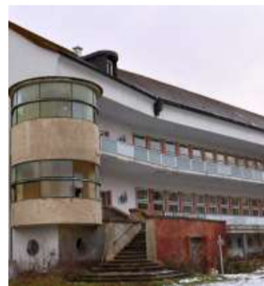
Heute ist die Treppe zum Ostflügel einsturzgefährdet. FOTO: HARTUNG
